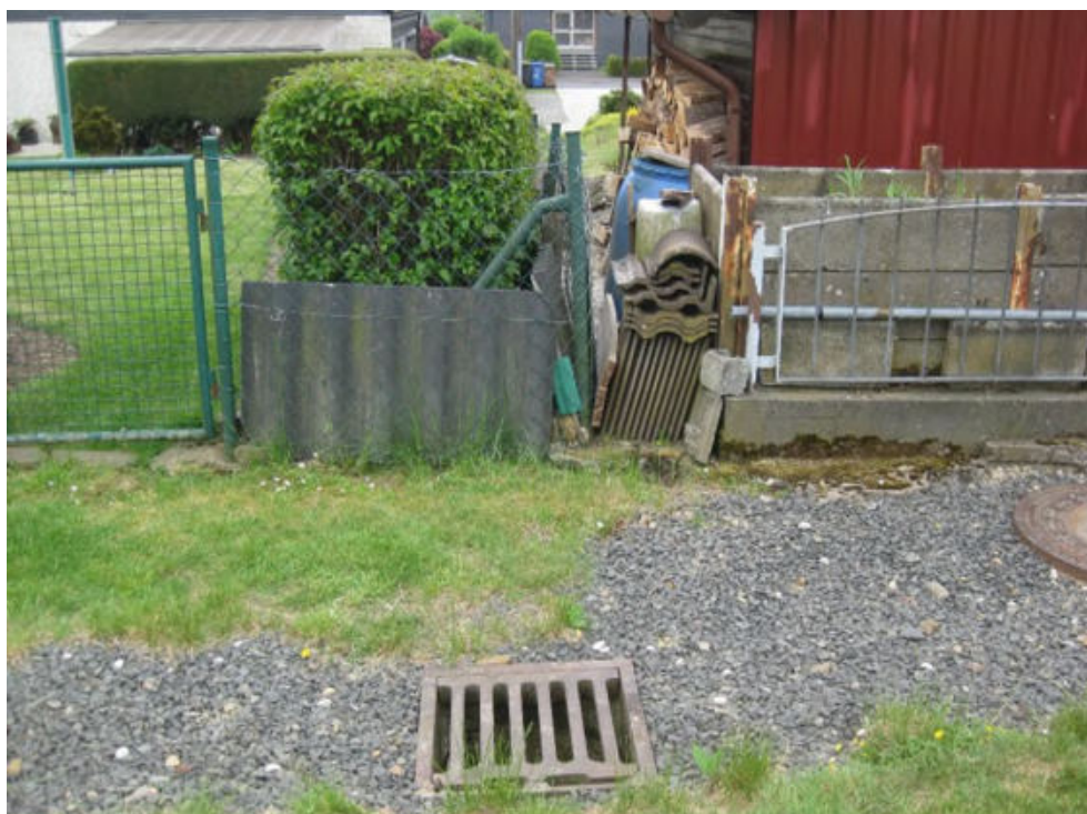
Abbildung 24: Rosenheim, Einlauf im Bereich „Im Kochbrunnen“ zwischen Nr.22 und 24; Gefahrenpunkt 5.4
