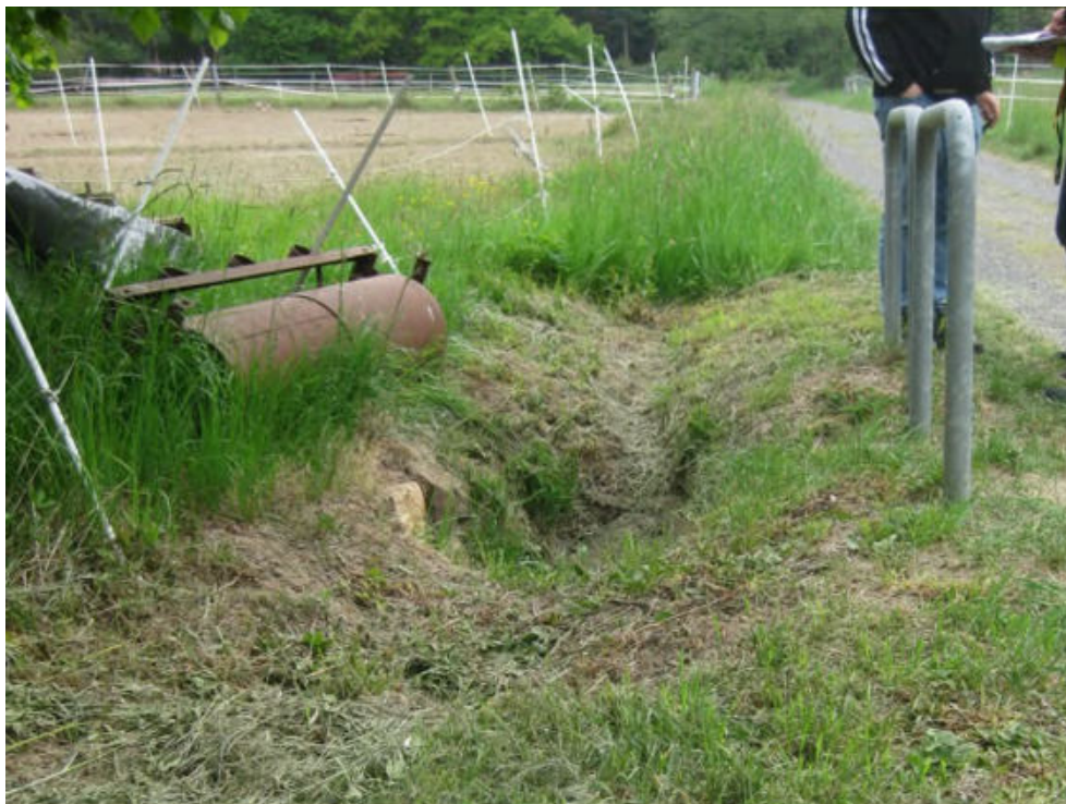
Abbildung 31: Rosenheim, nord-östliches Außengebiet „Im Acker“/Einlauf Graben; Gefahrenpunkte 5.3 und 5.10
