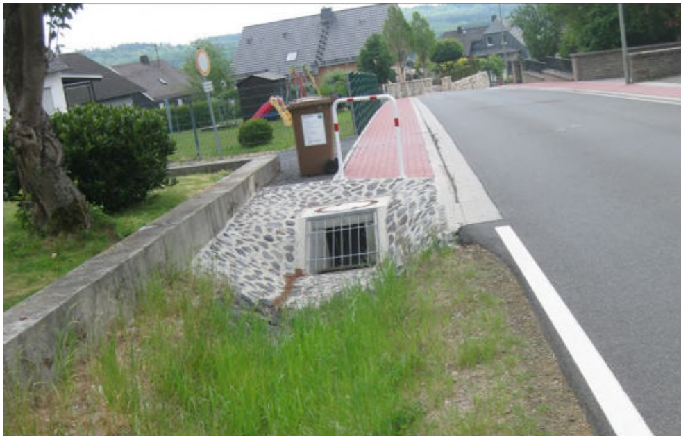
Abbildung 9: Rosenheim: Einlauf Graben in der Bergstraße; Gefahrenpunkte 5.5
