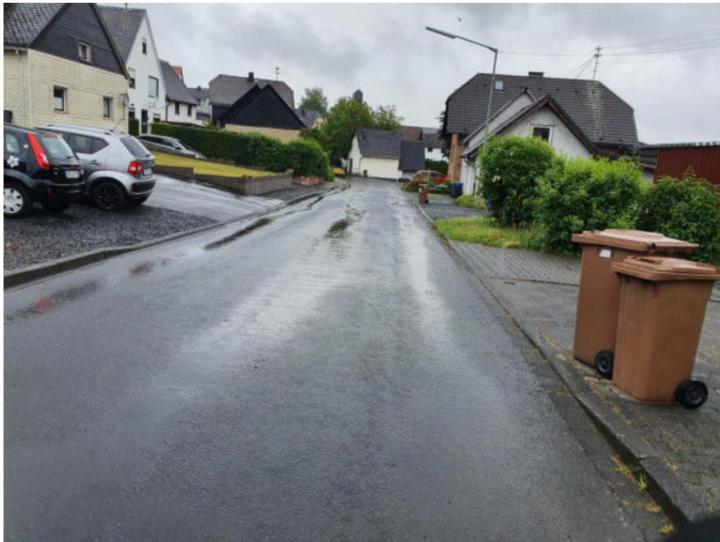
Abbildung 13: Nauroth, Mittelstraße/Südstraße; Gefahrenpunkt 6.2
