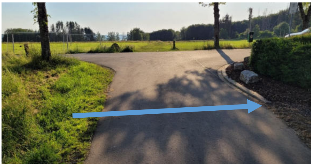
Abbildung 20: Nauroth, südliches Außengebiet, Überströmung der Straße und Übertritt auf privates Grundstück; Gefahrenpunkt 6.11
