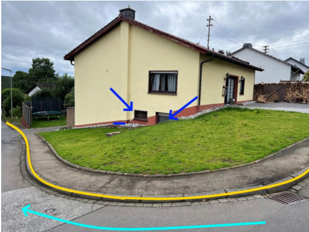
Abbildung 102: Notabflussweg "Auf der Höhe" mit Fließrichtung (hellblau), Objektschutzmaßnahmen (blau) und Bordanlagen (gelb)
