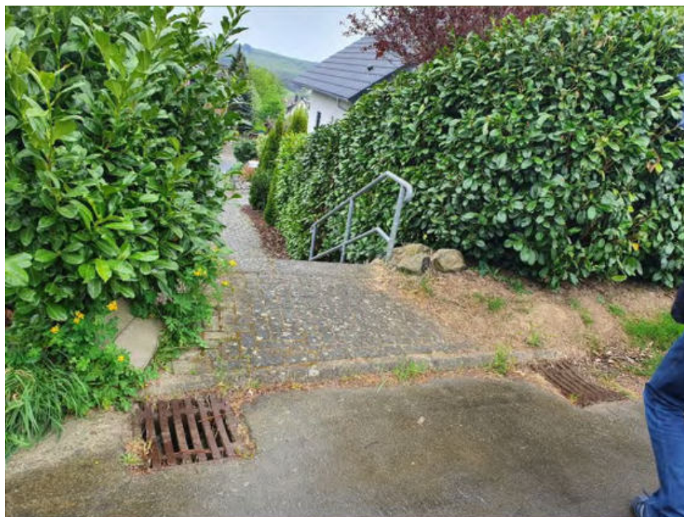
Abbildung 40: Zulauf aus Außengebiet auf Oberbergstraße Gefahrenpunkt 10.11
