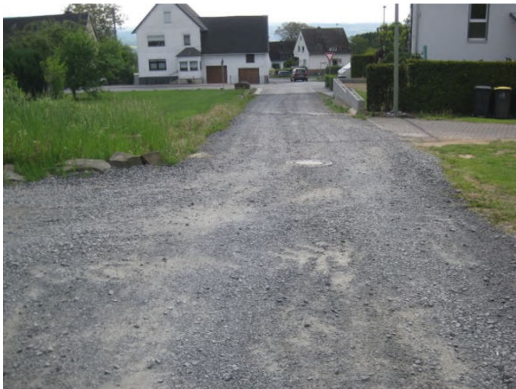
Abbildung 9: Malberg, Verlängerung Schulstraße mit seitlichem Graben; Gefahrenpunkt 4.1
