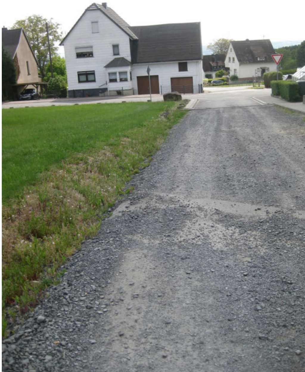
Abbildung 10: Malberg, Verlängerung Schulstraße mit seitlichem Graben; Gefahrenpunkt 4.1
