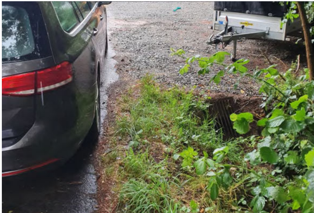
Abbildung 6: Malberg, Einlauf Außengebietswasser an der Poststraße; Gefahrenpunkt 4.4
