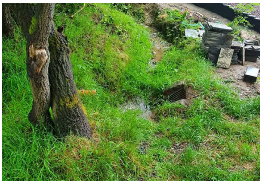
Abbildung 5: Malberg, Einlauf Außengebietswasser an der Poststraße; Gefahrenpunkt 4.4
