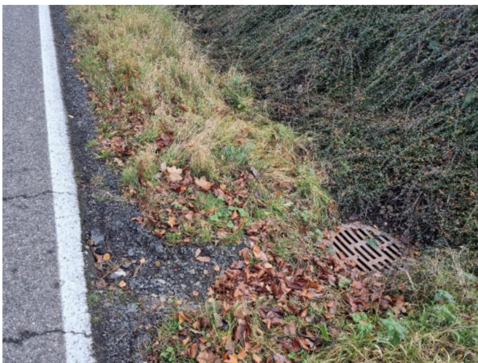
Abbildung 39: Einlauf im Graben an der Hauptstraße; Gefahrenpunkt 2.15
