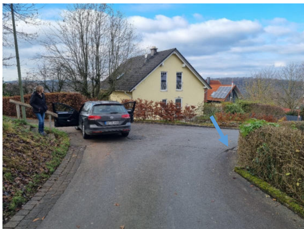
Abbildung 41: tiefster Einlauf in der Löhrstraße; Gefahrenpunkt 2.16
