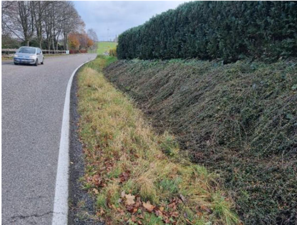
Abbildung 44: Graben entlang Hauptstraße; Gefahrenpunkt 2.17
