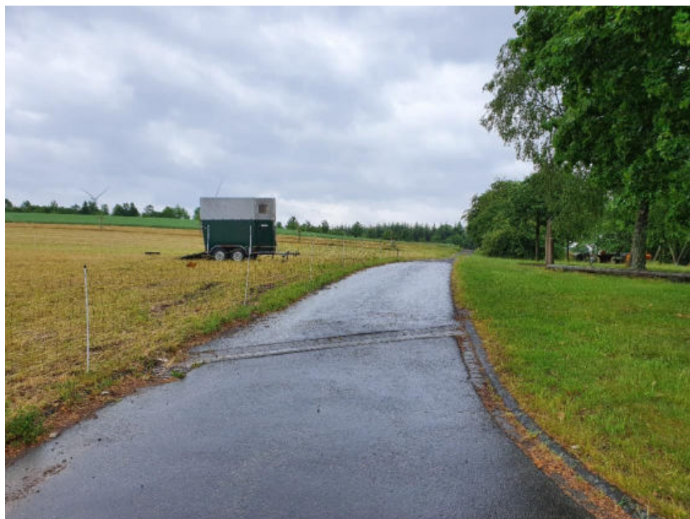
Abbildung 23: Zufluss aus Außengebiet im Bereich Bürgerhaus; Gefahrenpunkt 2.12
