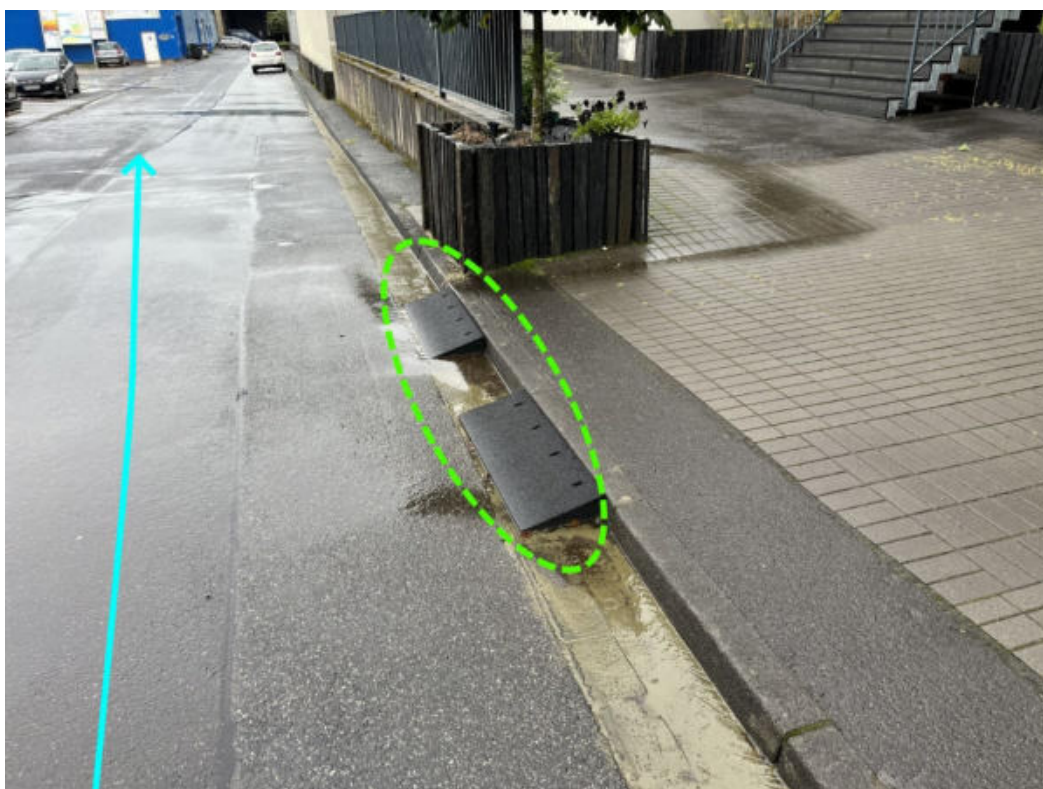
Abbildung 126: Notfließweg "In der Aue" mit Fließweg (hellblau) und Instandsetzung der Entwässerungseinrichtung (hellgrün)
