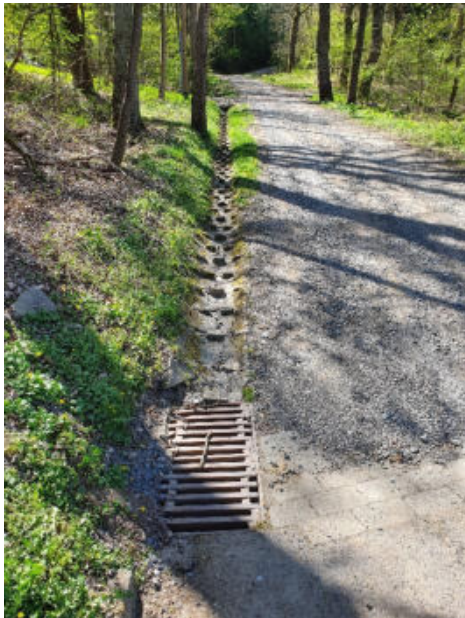
Abbildung 40: Forstweg im südlichen Außengebiet, Gefahrenpunkt 17.9
