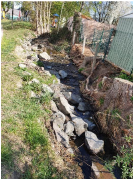
Abbildung 15: Scheuerfelder Bach parallel zur Industriestraße, Gefahrenpunkt 17.1
