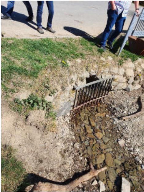
Abbildung 28: Einlaufgitters am Durchlass des Scheuerfelder Baches an der Waldstraße/Kupferkaute, Gefahrenpunkt 17.6
