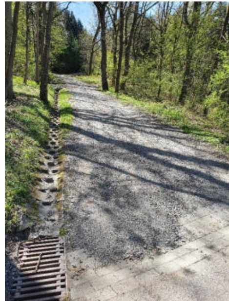
Abbildung 41: Forstweg im südlichen Außengebiet, Gefahrenpunkt 17.9
