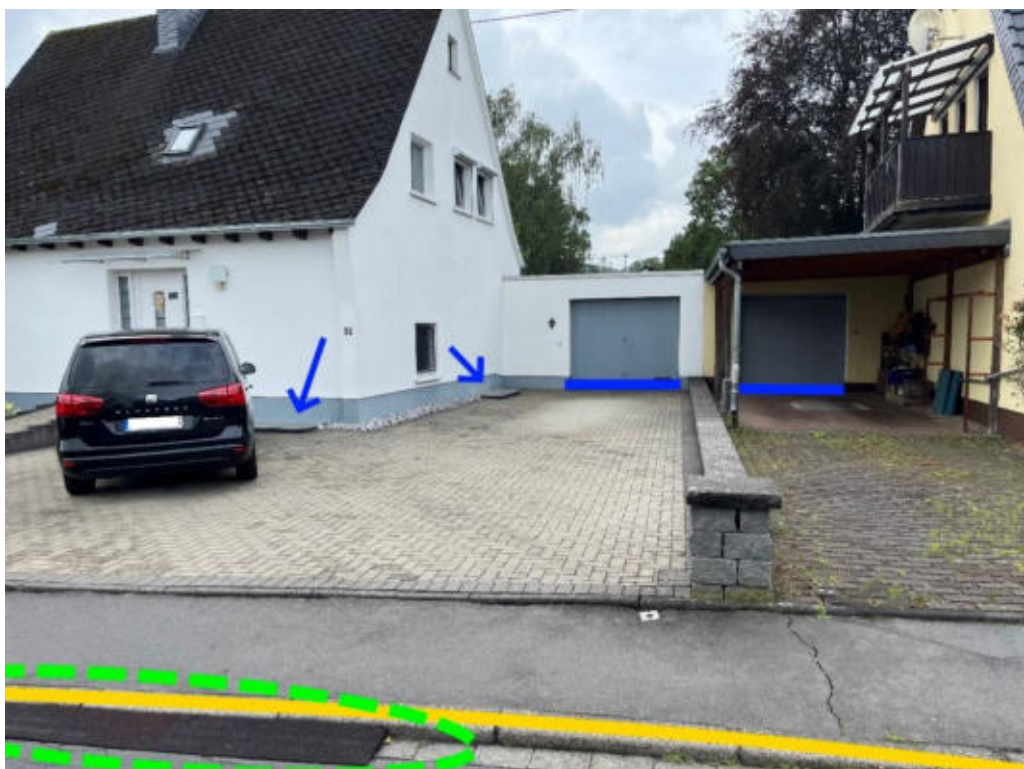
Abbildung 236: Notabflussweg „Birkenstraße“ mit Fließweg (hellblau), Objektschutzmaßnahmen (blau), Instandsetzung der Entwässerungseinrichtung (hellgrün) und Bordanlage (gelb)
