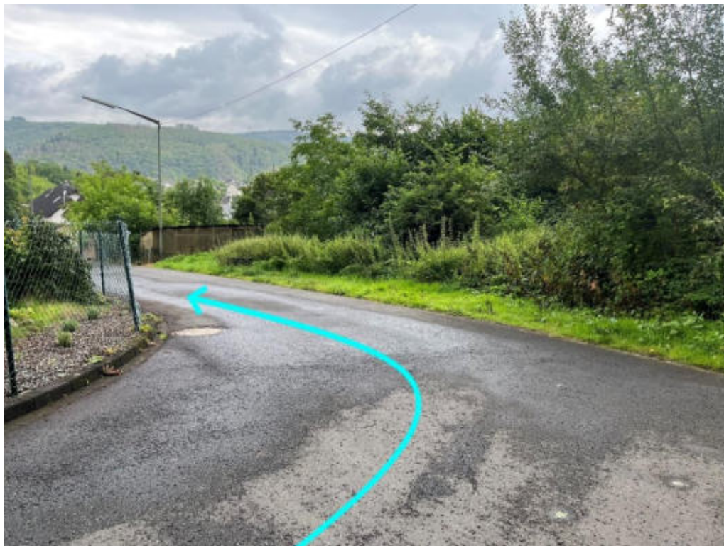
Abbildung 204: Notabflussweg „Pestalozzistraße“ mit Fließweg (hellblau)
