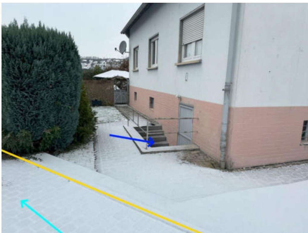
Abbildung 361: Notabflussweg „In der Gasse“ mit Fließweg (hellblau), Objektschutzmaßnahmen (blau) und Bordanlage (gelb)
