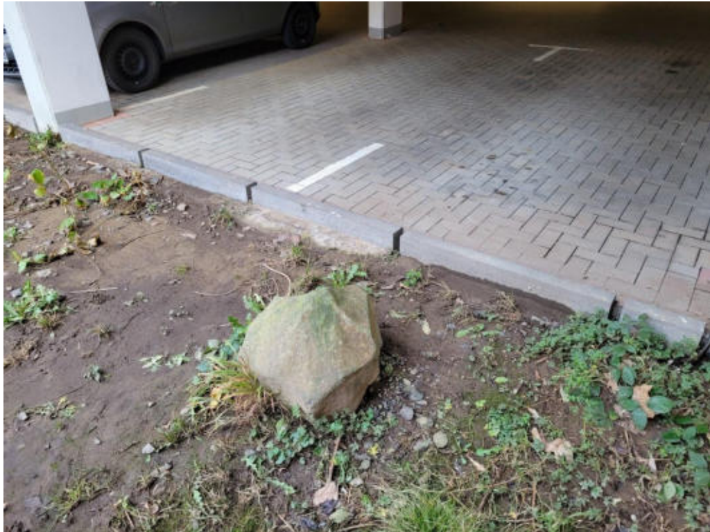
Abbildung 21: Betzdorf, Tiefgarage, flutbar, Vorrichtung für mobilen Hochwasserschutz
