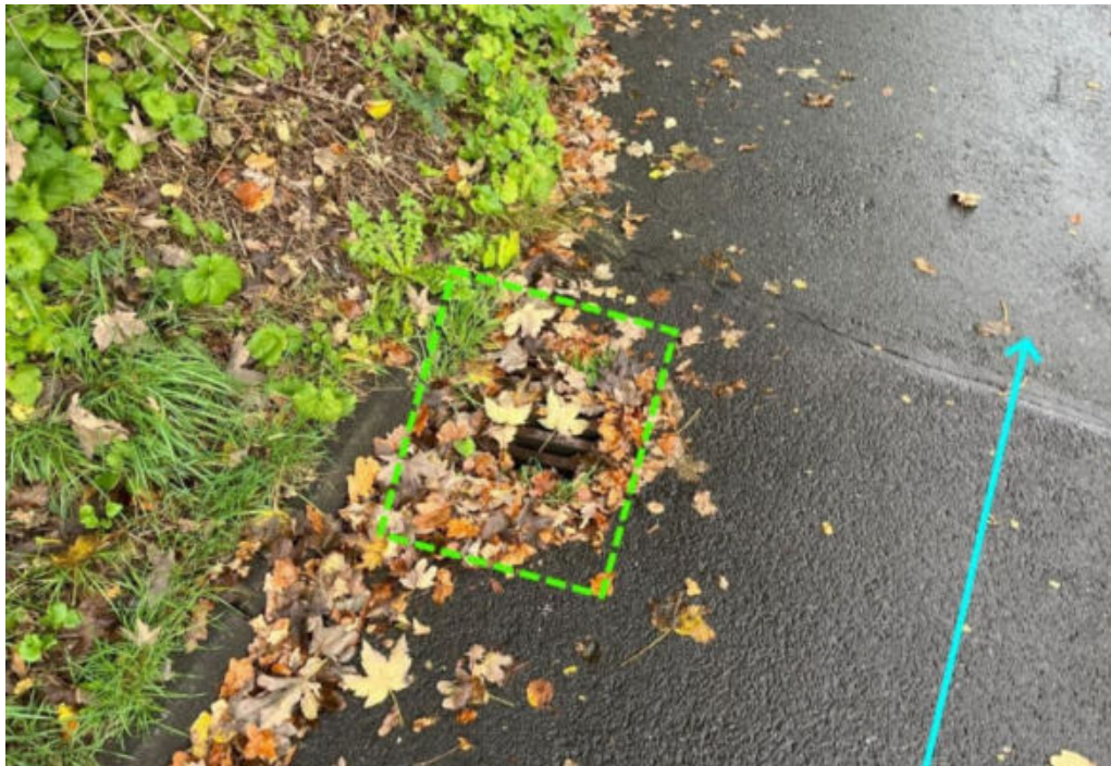
Abbildung 144: Notabflussweg "Im Sommer" mit Fließrichtung (hellblau) und Instandsetzung der Entwässerungseinrichtung
