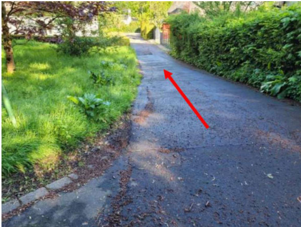
Abbildung 55: Oberflächenabfluss über den Tannenweg → Gefahrenpunkt 14.25
