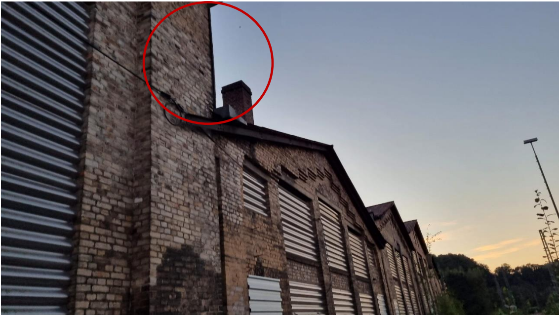
Abb. 14: An der nördlichen Seite befindet sich eine Wochenstube der Zwergfledermaus. Der exakte Standort konnte aufgrund schlechter Einsehbarkeit nicht ermittelt werden (ungefähr im Bereich des roten Kreises).
